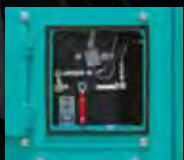
Válvula manual de emergencia para bajar la cabina
